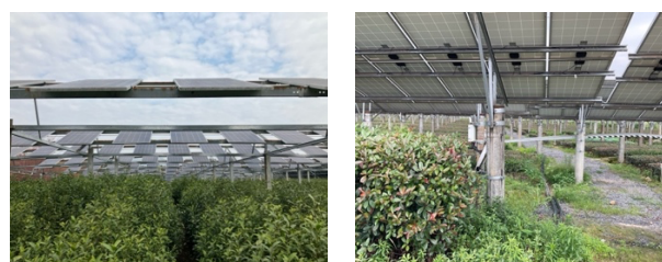
図 1a 営農本位型設置状況 図 1b 発電優先型設置状況
