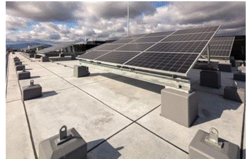
屋上 太陽光発電パネル（25kW）
